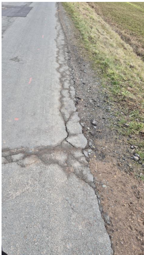
Obrázek 15 Poškození okraje vozovky při vzájemném míjení vozidel.
