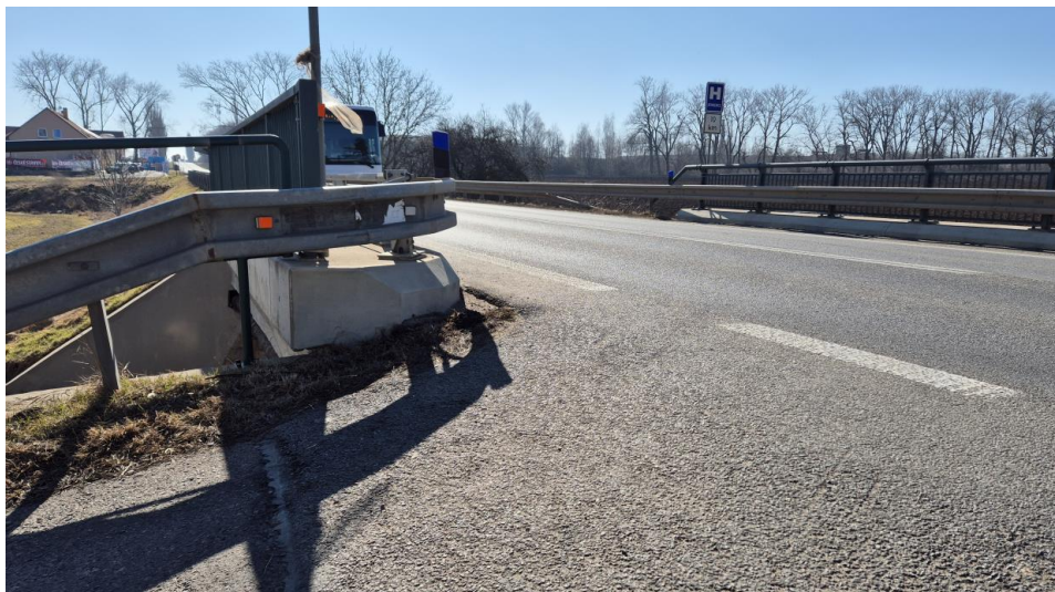
Obrázek 5 Svodidlo a zábradlí tvoří překážku v rozhledu směrem vlevo
