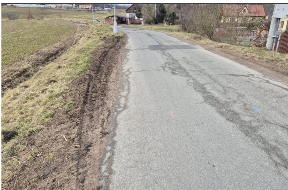
Obrázek 14 Poškození okraje vozovky při vzájemném míjení vozidel.
