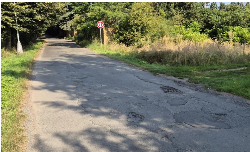
Obrázek 13 Špatný stavební stav komunikace.
