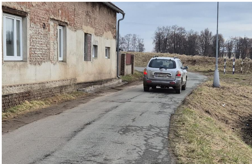
Obrázek 2 Šířka vozovky u domu čp. 255/18 v km 0,600 dosahuje zhruba 3,50 m, v pozadí směrový oblouk s nedostatečným rozhledem.
